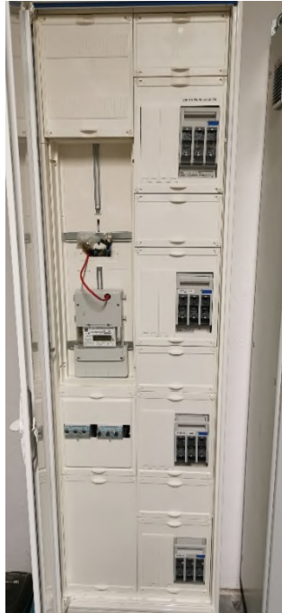
Abbildung 8 Verteil und Zäblerschrank
