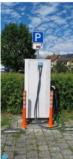
Abbildung 10 Schnellladesation 3 Ladepunkte 50kW 800V
