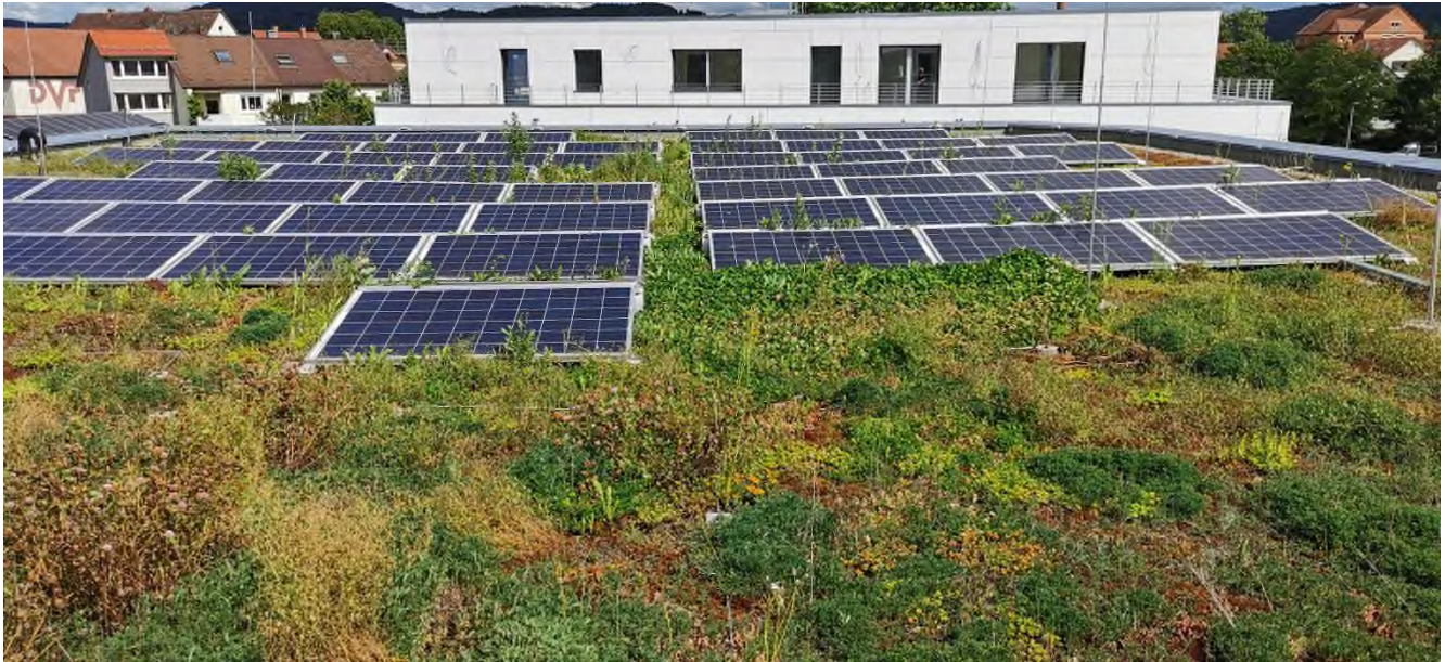
Abbildung 3 PV Anlage I
