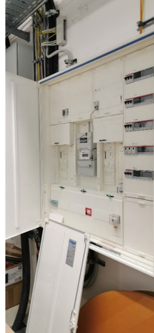
Abbildung 6 Unterverteilung und PV Zähler
